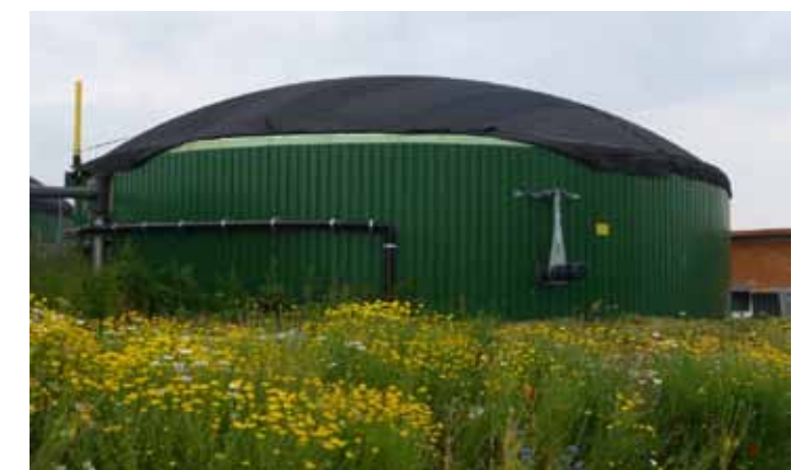
Abbildung 33: Biogasanlage Bäuerle in Kleinaspach
