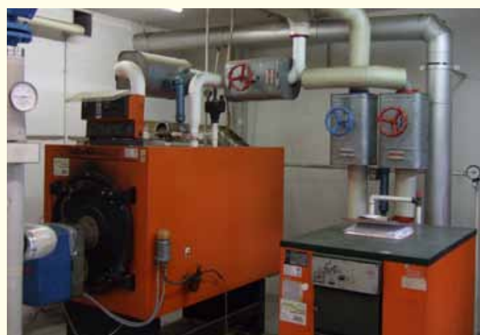
Abbildung 24: Sanierungsbedürftige Heizungsanlagen sind ein guter Anlass zum Umstieg auf Fernwärme.
