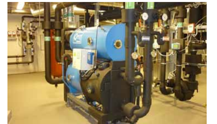
Abbildung 50: Technikraum mit AKA
