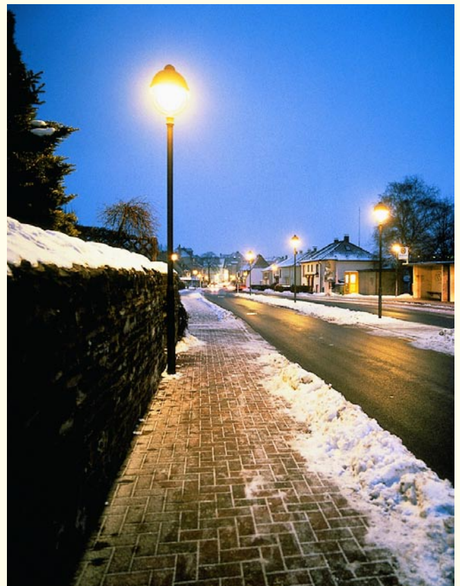
Energiesparende Kompaktleuchtstofflampen mit geringer Lichtpunkthöhe
