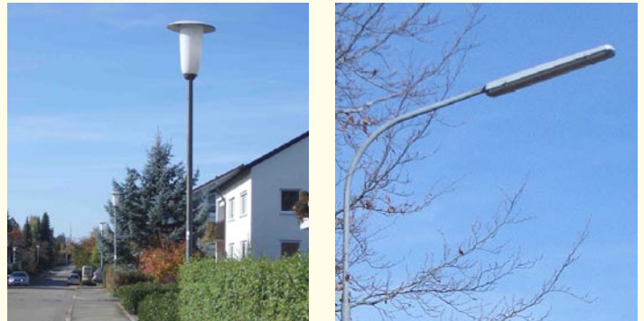
Veraltete Technik: Links Pilzleuchten mit Quecksilberdampflampen und rechts Leuchte mit Leuchtstofflampe
