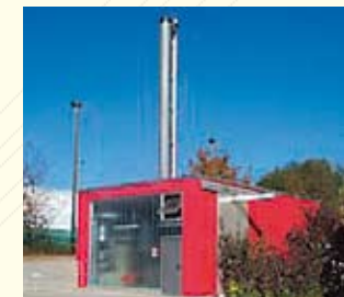
Schulzentrum Karlsbad-Langensteinbach: Die Holzhackschnitzel-Heizzentrale produziert 2.200 MWh pro Jahr. Sie wird mit dem in der Kommune anfallenden Landschaftspflegeholz und unbehandeltem Altholz betrieben.
